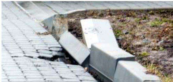
K opravě a předlážďení dojde u propadů a překopů na ulicích „Pod Skalou“ a „Spojovací“.
