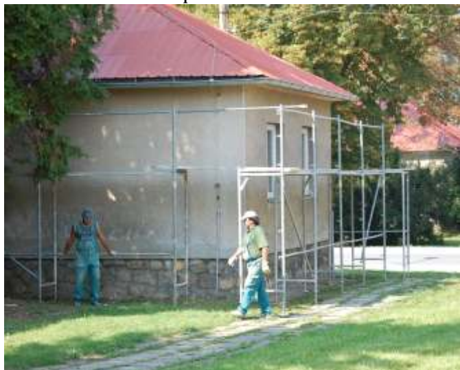
Stavbou lešení byly zahájeny práce na zateplení podzemní části Kulturního domu s úpravou balkónů, schodišť a prostranství v etně realizace přeložky elektrického vedení.
