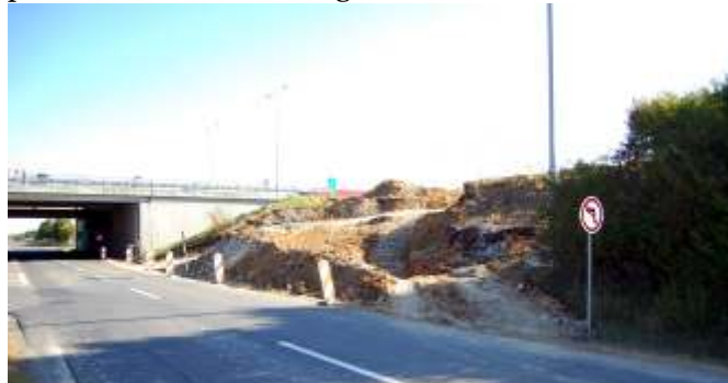
Ing. Blažák v diskusi informoval o součinnosti obce a dlouho očekávaném zahájení prací na vybudování dálničního nájezdu ve směru na Brno.
