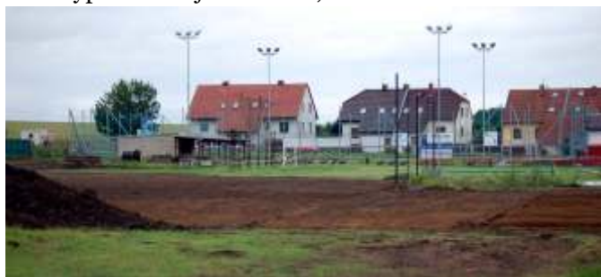
V měsíci červnu bylo provedeno srovnání terénu v sousedství nově budované lokality „Za Hřištěm“. Vzniká tak prostor pro plánované rozšíření sportovního areálu a zbudování dalších sportovišť. Tyto pozemky chceme v měsíci červenci svépomocí oplotit.
