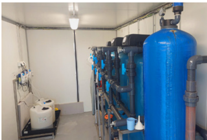
Úpravna vody v obci Vrchy u Opavy
